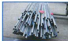
2重巻きで止められていない
